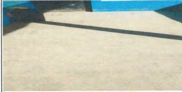
Foto 4: se instalará piso en las aulas solo se cuenta con loza de cemento.
