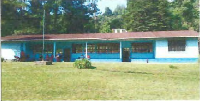
Foto 2: Ambas alas de lámina están dañadas.
