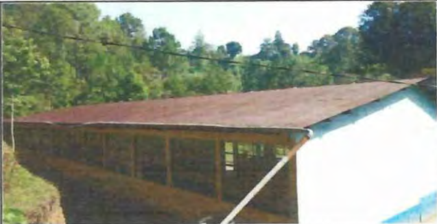
Foto1: Se sustituirá en su totalidad la lámina por deterioro , no así la estructura.
